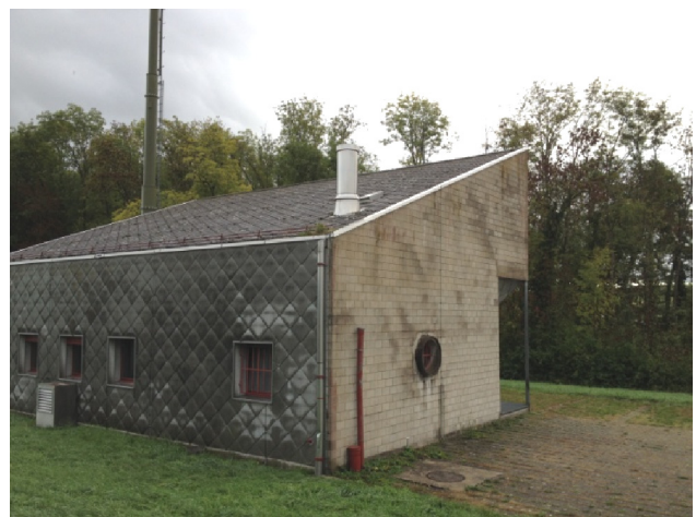
1 Neuer Schornstein auf einem Dach aus asbesthaltigem Faserzement
